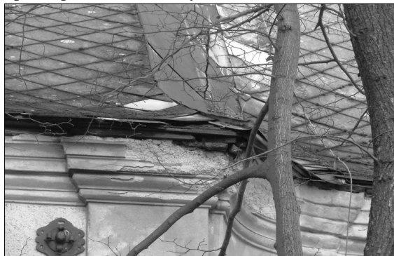
Fot. Poškozená římska a střecha na Vavřinečku
